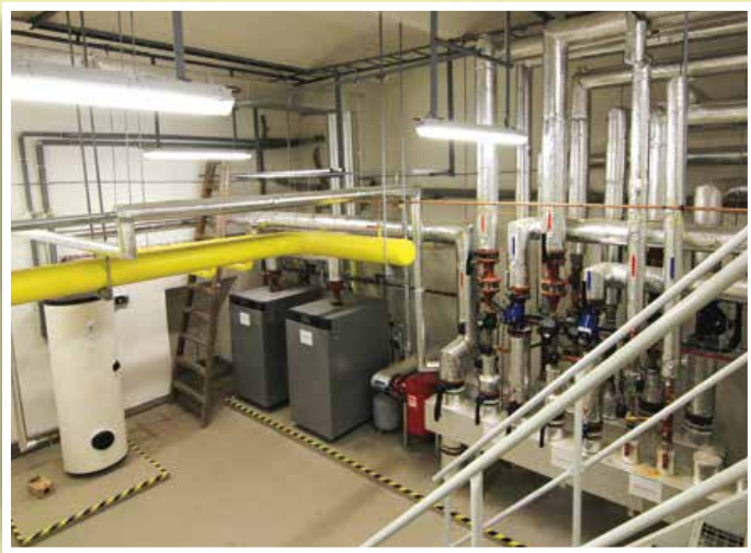
Kotelna (rekonstrukce provedena 2017).
